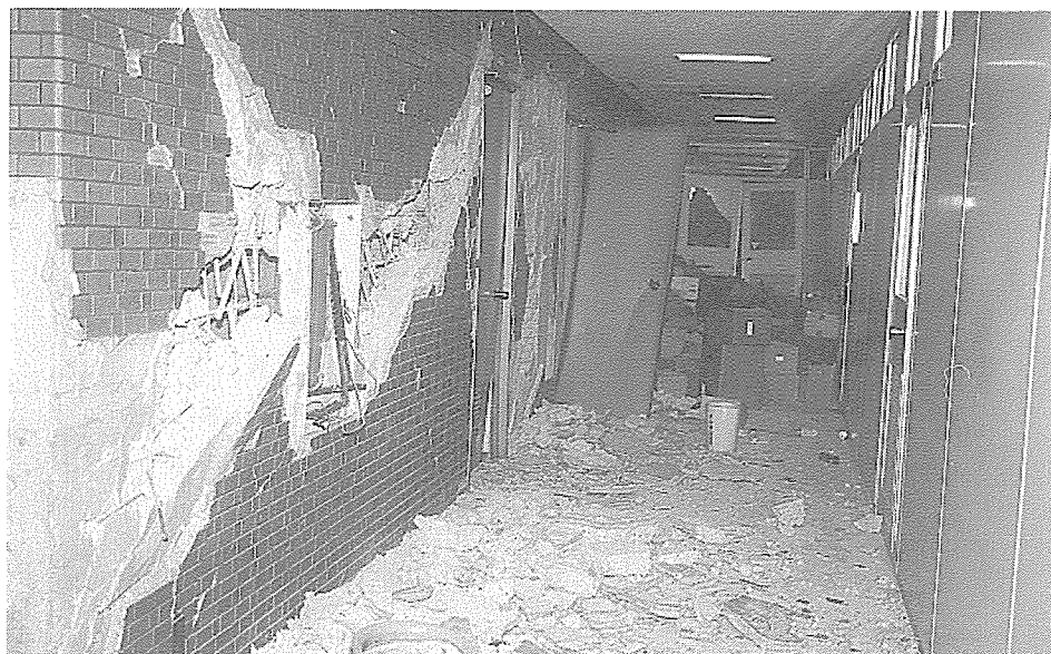
西宮市本庁舎7F 南東廊下（突きあたりが行政資料室：写真提供西宮市行政資料室）
