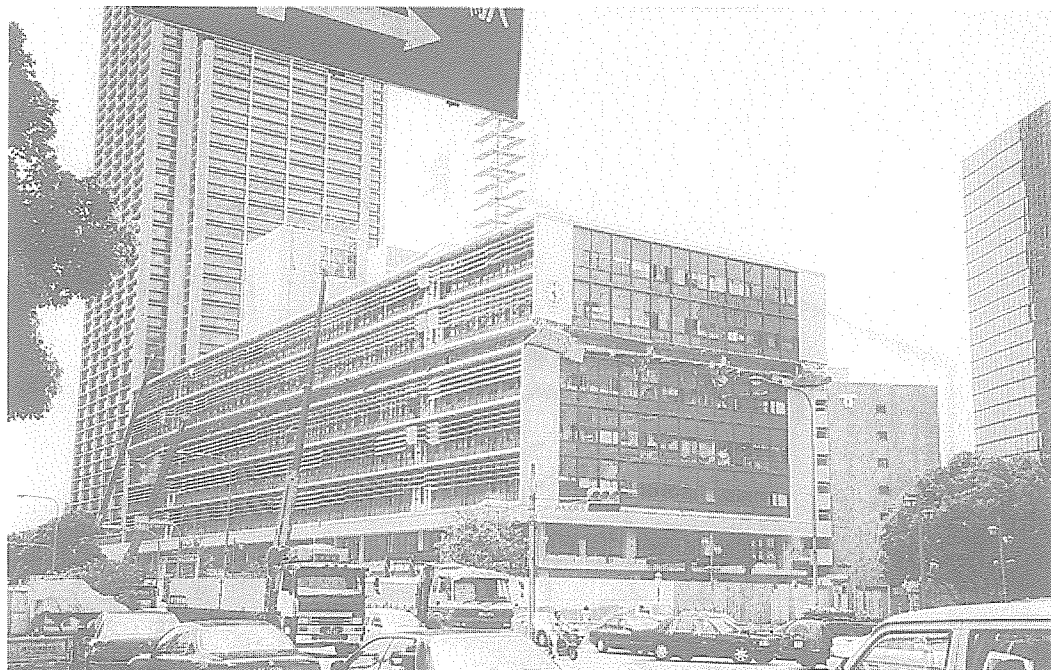
6階部分が中間壊破壊を起こした神戸市役所2号館 左奥に見えるのが平成元年完成の1号館
